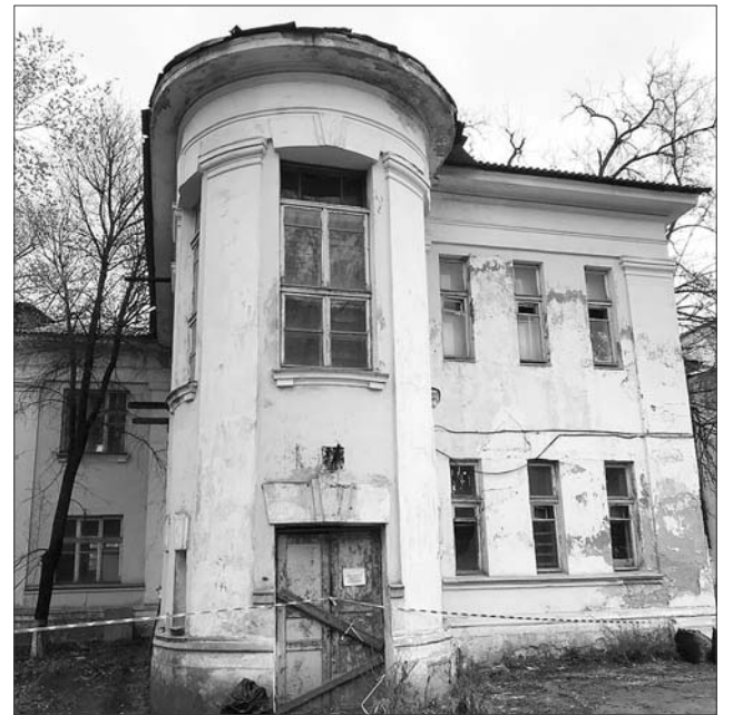
Здание терапевтического отделения требует реконструкции.
